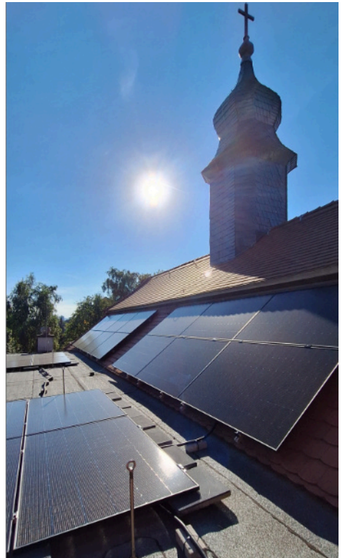
Photovoltaikanlage auf der Kirche „Mariä Himmelfahrt“
